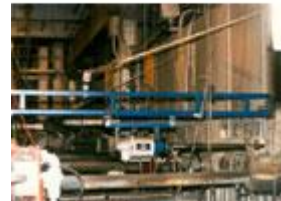
Sistema instalado refrigerado por agua Lenox
