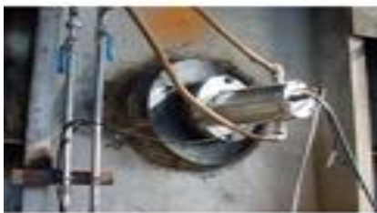
Cámara de horno refrigerada por agua
